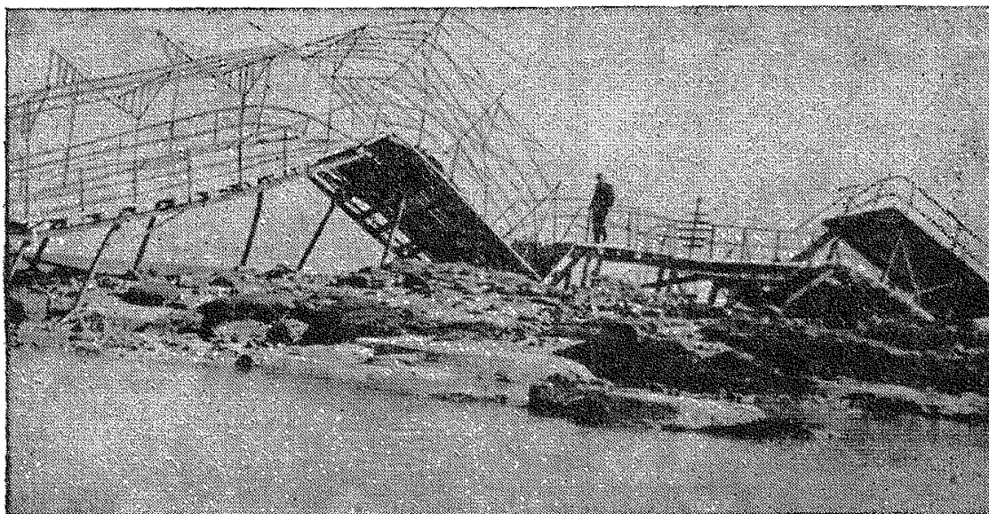
Рис. 63. Вал выпирания на мелководье в Одессе и деформированный оползнем пирс (фото Одесской оползневой станции)
